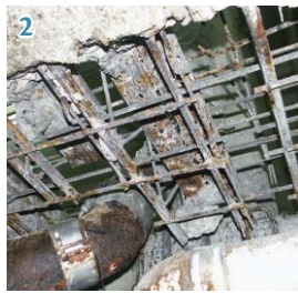
2 Freigelegter Bereich aus Bild 1, jedoch Deckenunterseite. Die Bewehrung ist überwiegend stark korrodiert.
