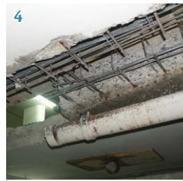
4 Freigelegte Bewehrung nach Abtrag des Betons im Bereich einer Querfuge der Fahrgasse (Deckenunterseite).
