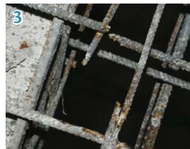
3 Detailaufnahmen zu Bild 1 und 2. Massive Bewehrungskorrosion mit Lochfraß hat teilweise zum vollständigen Querschnittsverlust der Bewehrung geführt.
