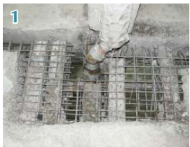
1 Freigelegte Bewehrung nach Abtrag des chloridbelasteten Betons im Bereich einer Bauwerksfuge und Deckendurchdringung (Entwässerungsleitung).
