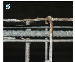
5 Die Detailaufnahme der Bewehrung zu Bild 5 zeigt ebenfalls eine stark korrodierte Bewehrung mit Querschnittsverlust.
