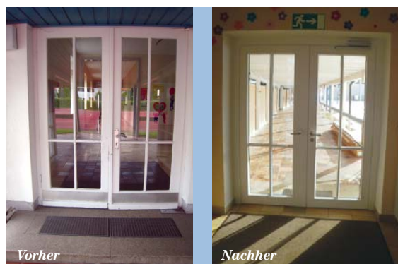
Neue Türen mit Panikbeschlägen sorgen nicht nur für Energie-Einsparung, sondern auch für mehr Sicherheit.
