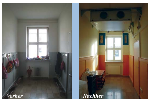
Sorgen nun für ein ausgeglichenes Klima: Die neuen Lüftungsanlagen in den Garderobenräumen.
