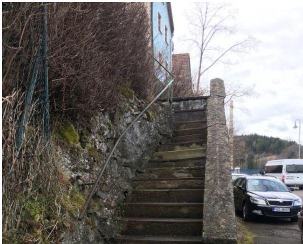
Abb. 28: Sanierungsbedürftige Mauer in der Tiroler Straße
