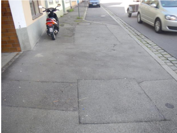
Abb. 27: Gehwege in schlechtem Zustand in der Lechvorstadt
