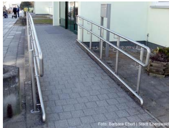
Abb. 57: Rampe nach DIN-Norm in Eberswalde
