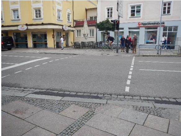
Abb. 43: Zu optimierende Bordsteinabsenkung
