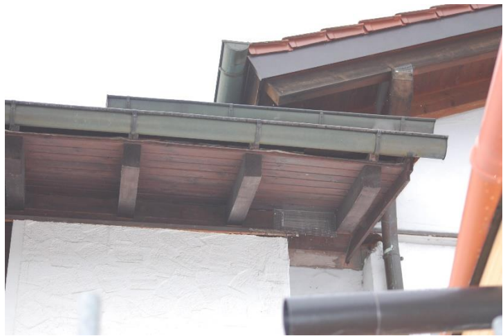
Detailansicht der nördlichen Fassade mit Einflugmöglichkeiten unter der Dachrinne.
